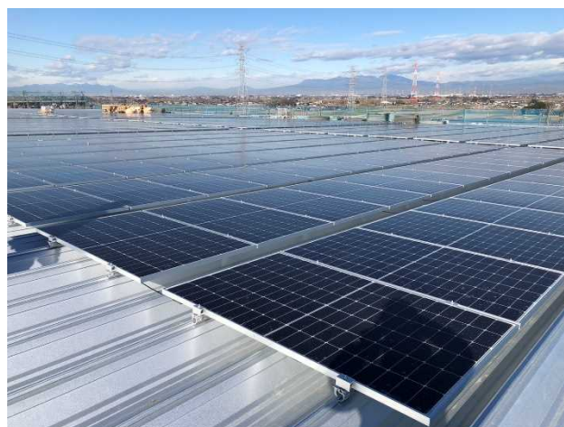
太陽光パネル
